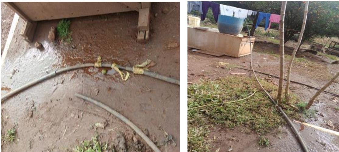
Figura 2 - Instalações hidrossanitárias típicas com mangueira preta.
