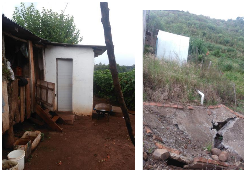
Figura 3 - Módulo sanitário, à esquerda, e sistema esgotamento deteriorado, à direita.
