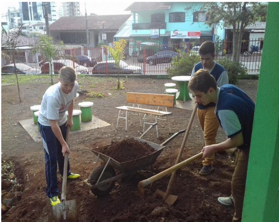
Figura 6 - Estudantes da Escola construindo o dreno no terreno ou espaço da Escola
