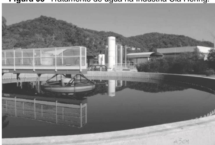
Figura 05- Tratamento de água na Indústria Cia Hering.
