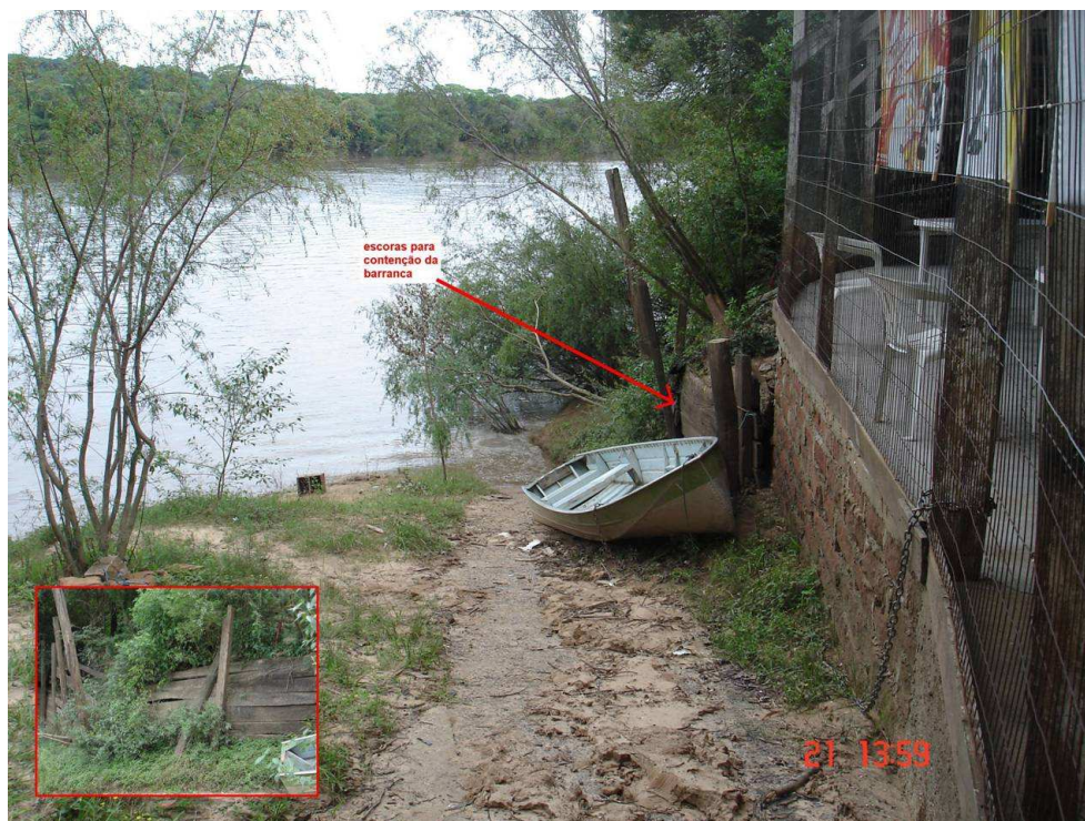
Foto 3 - Construções sobre os terraços fluviais (barranca) do rio Jacuí, com escoras para contenção da barranca. No detalhe, as precárias escoras em madeira.
