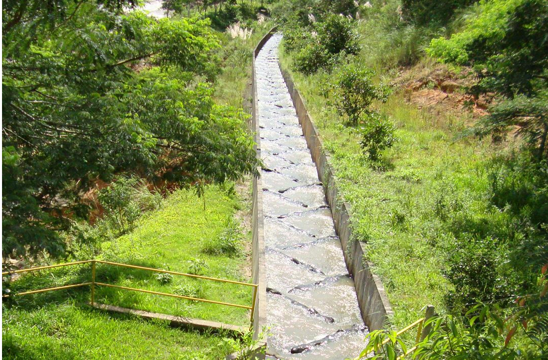
Figura 10 – Escada para peixe revestida com pedras na usina de Salto Forqueta.
