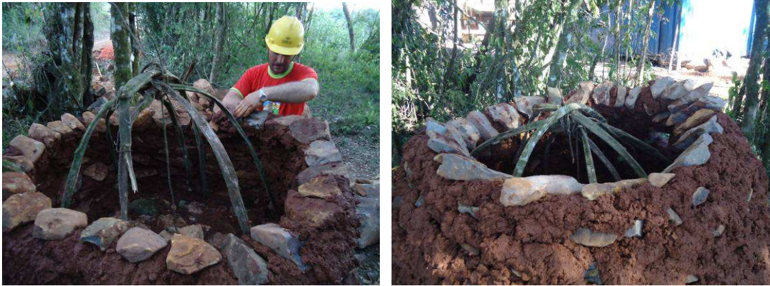
Colocação de armação interna com cipó para segurar as paredes antes da queima
