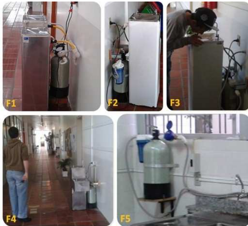
Figura 2 - Imagens dos filtros testes F1, F2, F3, F4 e F5 instalados em pontos de consumo no campus da UNISC.
