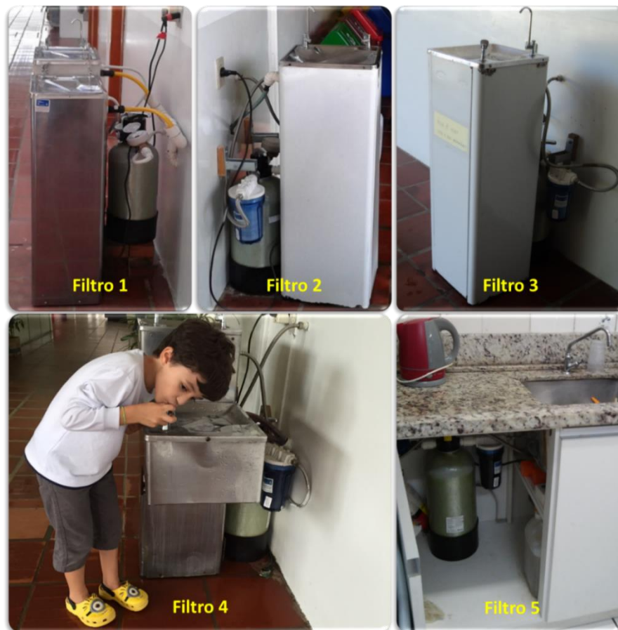
Figura 1. Sistemas de filtração por adsorção em filtros instalados nos bebedouros localizados nos blocos 08 e 13 da UNISC.
