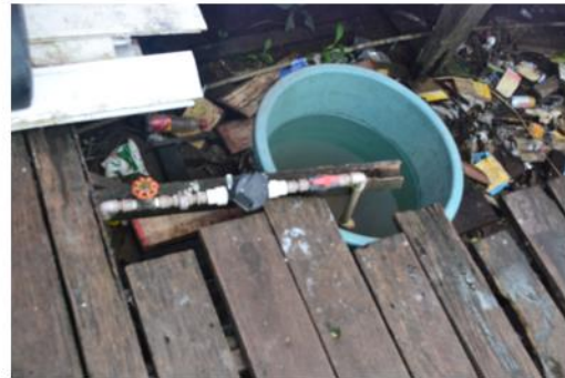
Figura d) A falta de água e as alternativas precárias possíveis na captação da água aos moradores, uma alta exposição de risco para a saúde.
