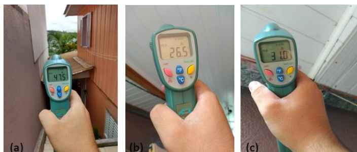
Figura 3 – Avaliação da cobertura composta por múltiplas camadas (metal, EPS, ar e PVC)
